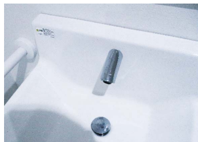
自動水栓による節水
