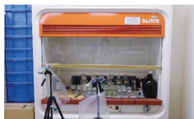
局所排気装置の定期自主検査
